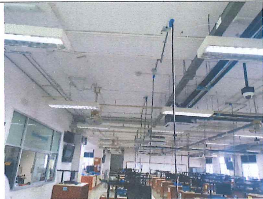
ภาพแสดงงานระบบไฟฟ้าเดิม ผู้เสนอราคาได้ต้องการเปลี่ยนคอมตามแบบรูปรายการ
